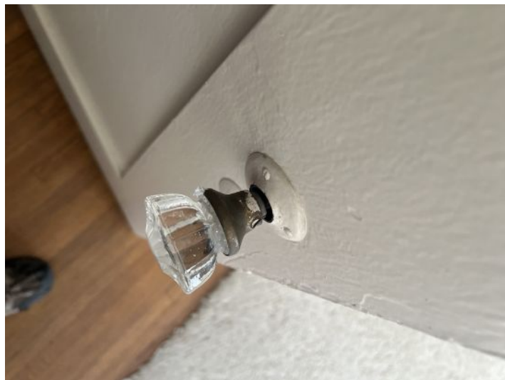
Door handle loose
